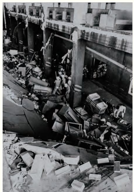
昭和43（1968）年 十勝沖地震で被災した青森栈橋待合室内部
